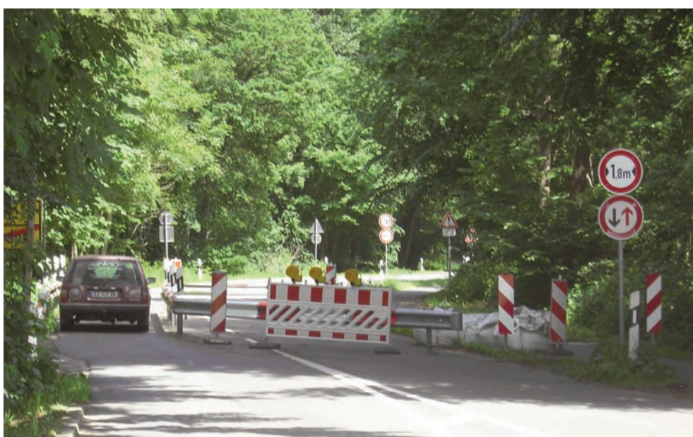
Wie lange bleibt den Verkehrsteilnehmern auf der L 116 von Lägerdorf in Richtung Breitenburg diese "Schikane" noch erhalten?
